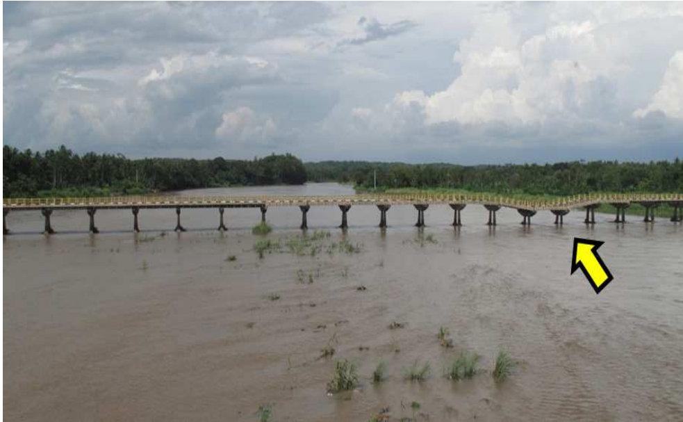
Gambar 1.6 Kegagalan konstruksi jembatan Srandakan Bantul
