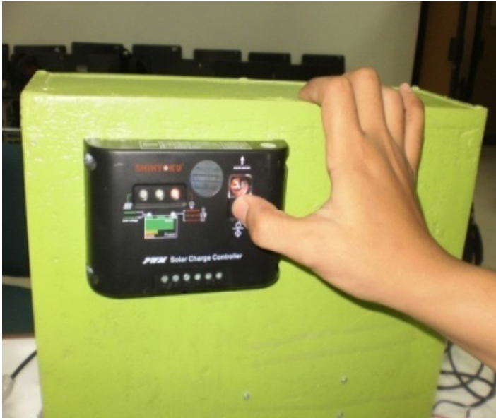
c. ATS tampak belakang
