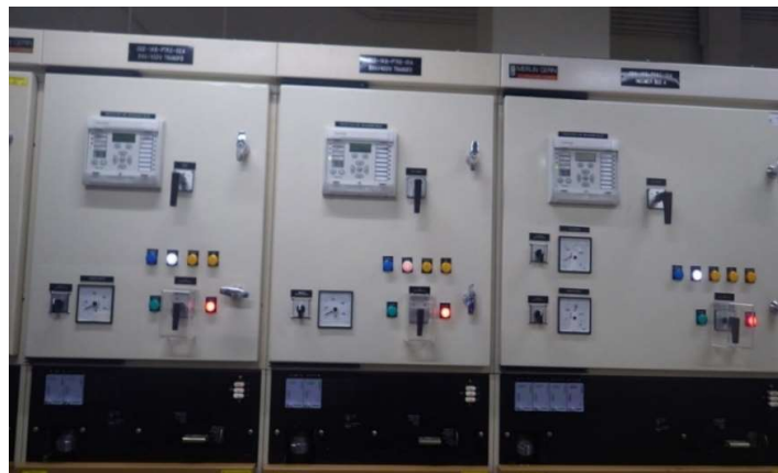
Gambar 2. 8 Control Panel Device di PT.Pertamina RU-VI Balongan
