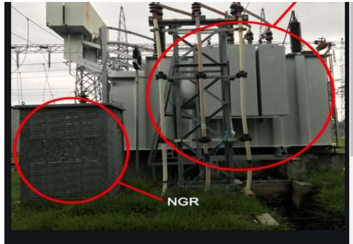
Gambar 2. 3 Sumber: Transformator 2 dengan NGR GI Gianyar
