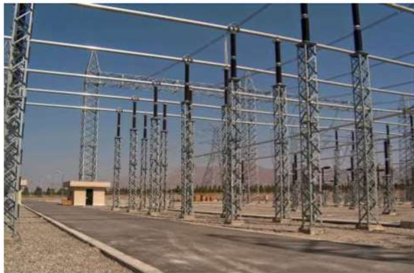
Gambar 2. 12 Bentuk Fisik Rel Busbar (Sumber: https://scadaku.wordpress.com )
