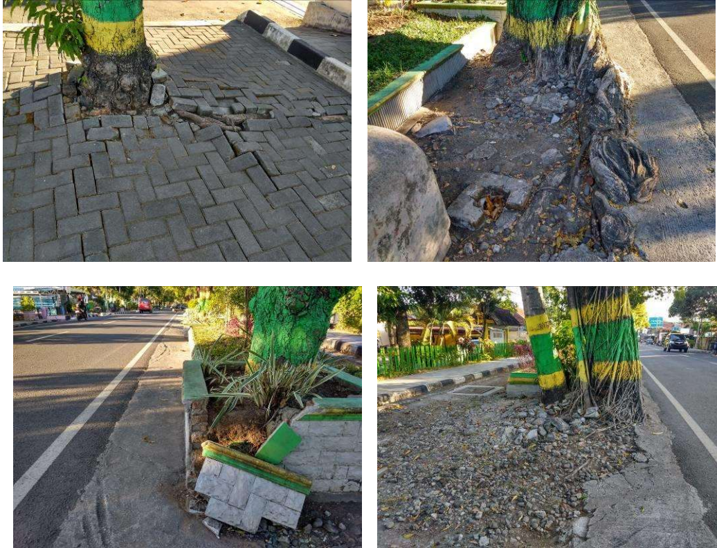
Gambar 12. Kerusakan di Jalan Sugiman
