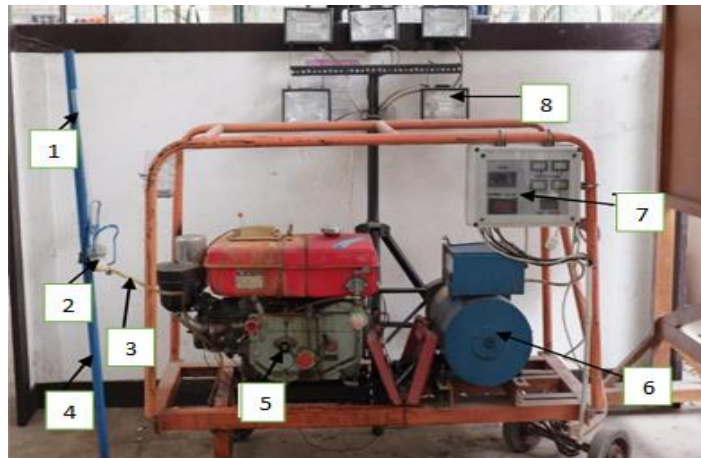
Gambar 3.2 Mesin Diesel dan Generator
