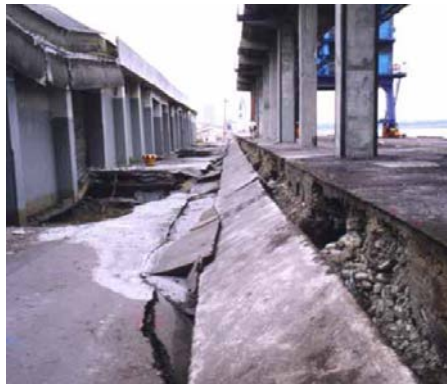
(b) Kerusakan struktur pelabuhan akibat penurunan tanah Gambar 1.6: Kerusakan infrastruktur pelabuhan Taichung akibat peristiwa likuifaksi. Sumber : NCREE, 2007
