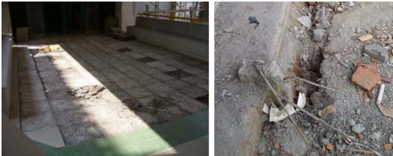
Gambar 1.5: Penurunan lantai di gedung Laboratorium UMY akibat peristiwa likuifaksi
