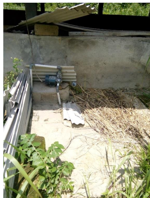
(Instalasi Air: Pompa)
