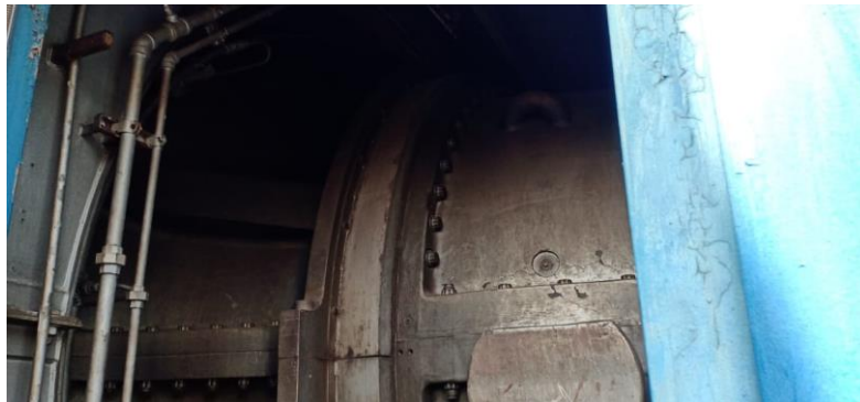
Gambar 2. 5 Kompresor pada GTG 2.2
