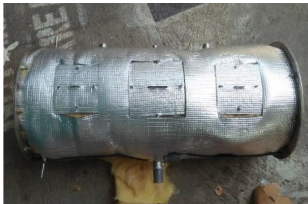
Gambar 3. 7 Tangki SWH sudah terpasang glasswool dan aluminium foil
