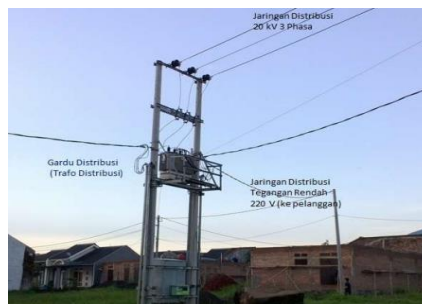
Gambar 3. Gardu Jaringan Tegangan Menengah
