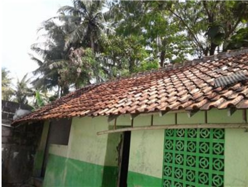
Foto 14 tampak bangunan yang berisiko tertimpa pohon apabila terjadi bahaya angin, gempa, maupun kebakaran.
