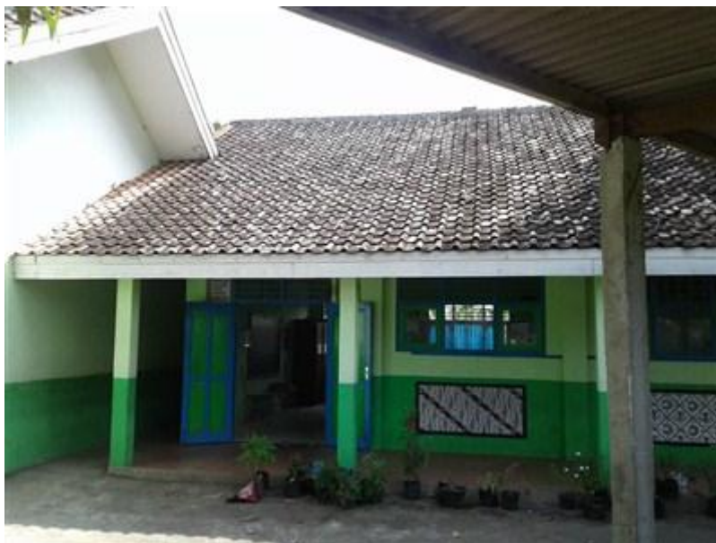
Foto 15 tampak dua bangunan sekolah yang berdekatan yang berisiko runtuhnya bangunan sehingga menimbulkan efek domino apabila terjadi bahaya gempa. Atap genteng dengan perletakan sederhana yang berisiko menimpa para penghuni sekolah apabila terjadi bahaya gempa dan angin. Risiko runtuhnya struktur atap yang terbuat dari kayu apabila terjadi kebakaran.
