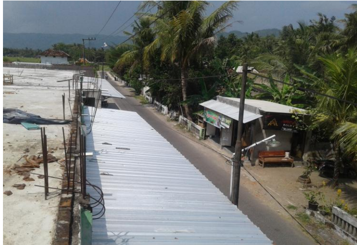
Gambar 4.15 Tampak tiang kabel listrik dekat bangunan sekolah
