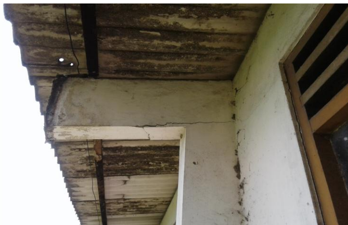
Gambar 4.16 Tampak retakan pada tembok bagian belakang sekolah
