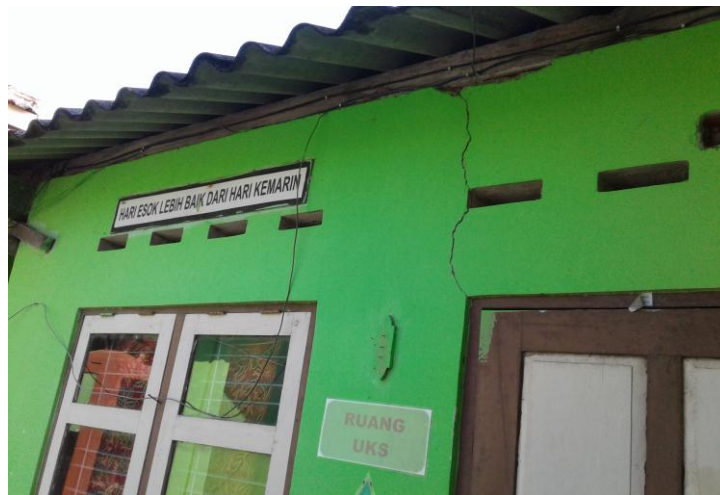
Gambar 4.11 Retakan tembok ruang UKS
