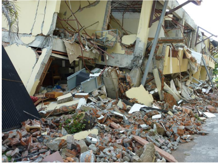
Gambar 1.3: Keruntuhan bangunan dua lantai akibat gempa bumi di Padang, 30 September 2009
