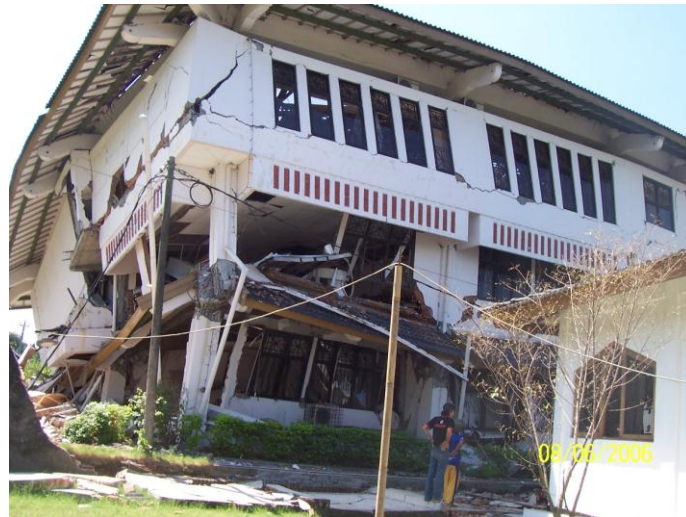
Gambar 1.4: Kegagalan struktur pada bangunan dua lantai akibat gempa bumi di Yogyakarta, pada 27 Mei 2006
