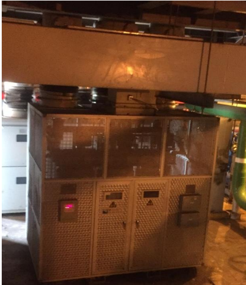
Gambar 2. 22 Trafo eksitasi (Sumber: Setyo,2019)
