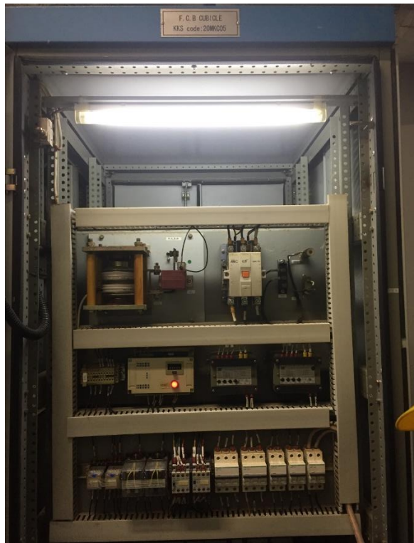
Gambar 2. 27 Cubicle FCB tampak depan (Sumber: Setyo, 2019)
