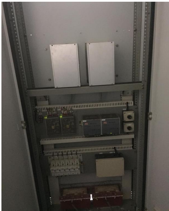
Gambar 2. 24 Cubicle AVR tampak belakang (Sumber: Setyo, 2019)
