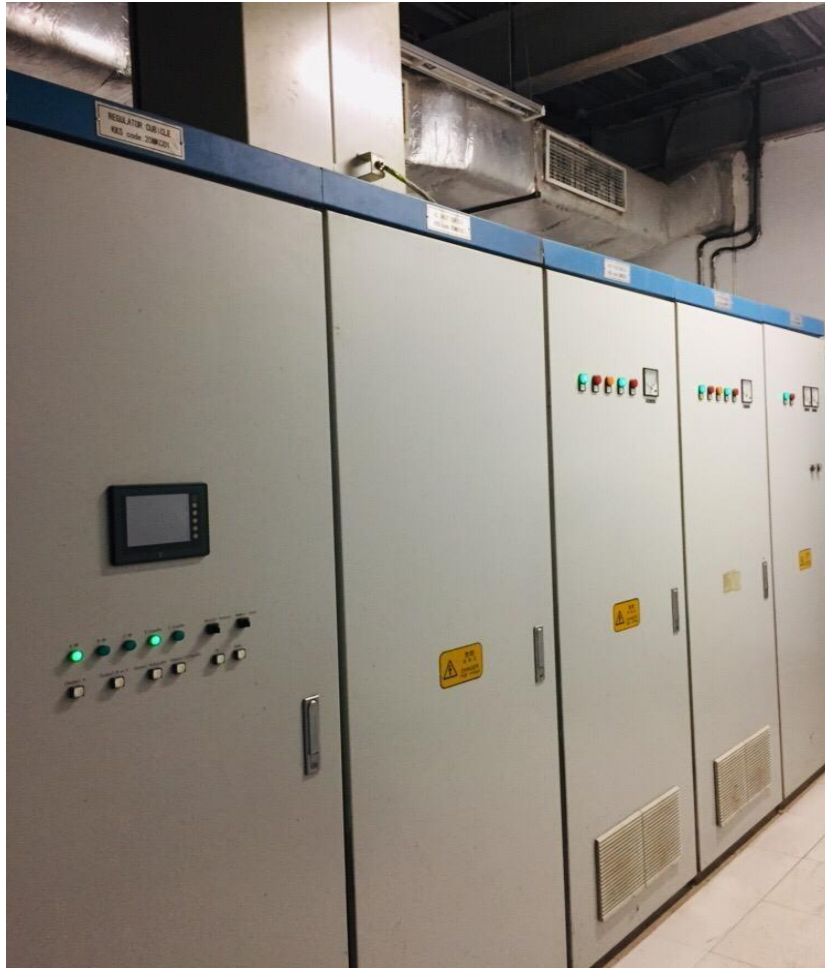
Gambar 2. 21 ruang cubicle sistem eksitasi (Sumber: Setyo,2019)
