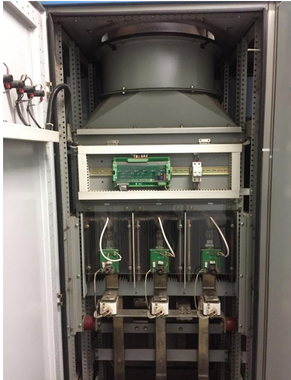
Gambar 2. 25 Cubicle rectifire tampak depan (Sumber: Setyo, 2019)
