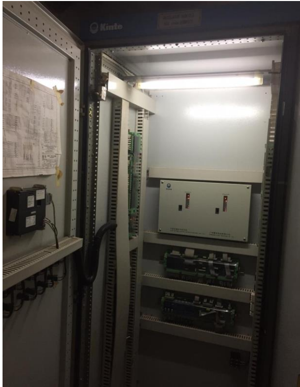
Gambar 2. 23 Cubicle AVR tampak depan (Sumber: Setyo,2019)
