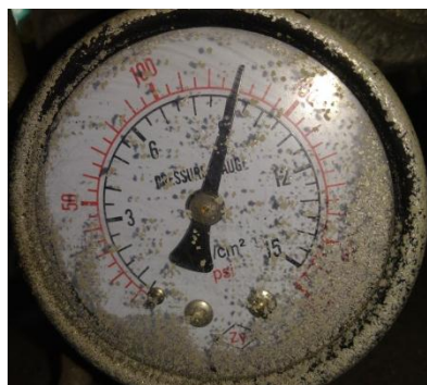
Gambar 4.11 Pressure gauge pada compressor menunjuk angka 130 psi
