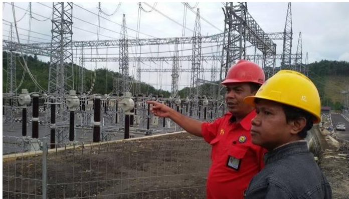
Gambar 3.6: Karakteristik gardu induk yang terhubung dari induk mambong Sesco Malaysia di Bengkayang (Sumber: Tribun Pontianak.co.id)
