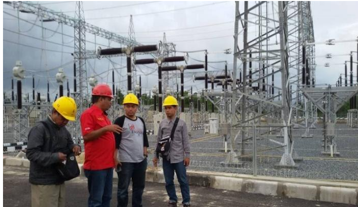
Gambar 3.5: Karakteristik gardu induk yang terhubung dari induk mambong Sesco Malaysia di Bengkayang (Sumber: Tribun Pontianak.co.id)
