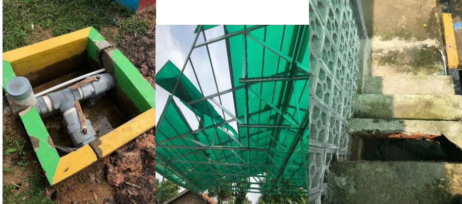
Gambar 4.5 kondisi bagian bangunan proyek yang rusak
