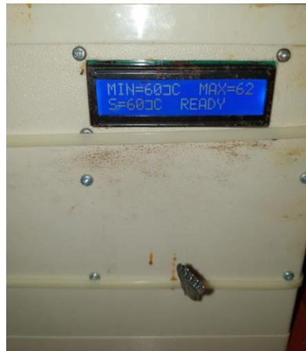
Gambar 4. 5 Pengujian Heater Suhu Air Mencapai Suhu Minimal
