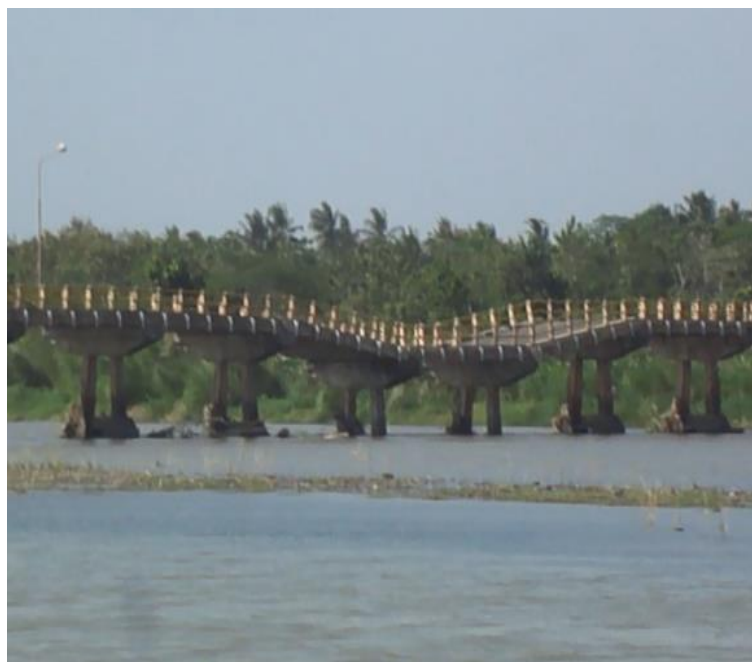
Gambar 1.1. Turunnya pilar Jembatan Srandakan (Istiarto, 2013)
