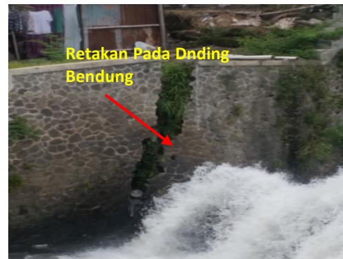
Gambar 11 Dinding Bendung Mengalami Kerusakan.
