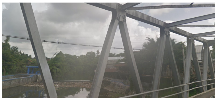
Gambar 4.39 Kondisi sempadan sungai Winongo di Jalan Bantul
