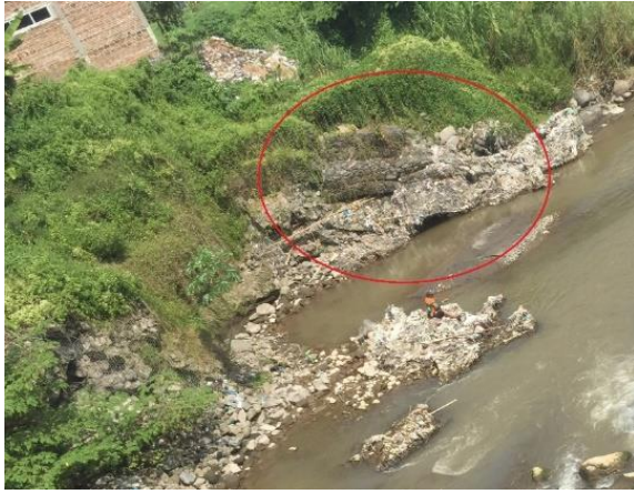
Gambar 4. Gerusan pada dinding penahan tanah
