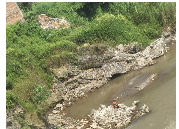
Gerusan yang terjadi di Dinding Penahan Tanah
