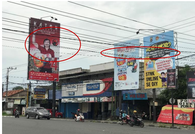
Gambar 4.48 Baliho yang terlalu dekat dengan tiang listrik
