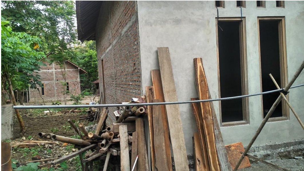
Foto 16 Tampak samping bangunan, dinding luar bangunan belum dipleser. Terlihat juga bekas sisa-sisa kayu dan papan pembuatan balok dan kolom bangunan.
