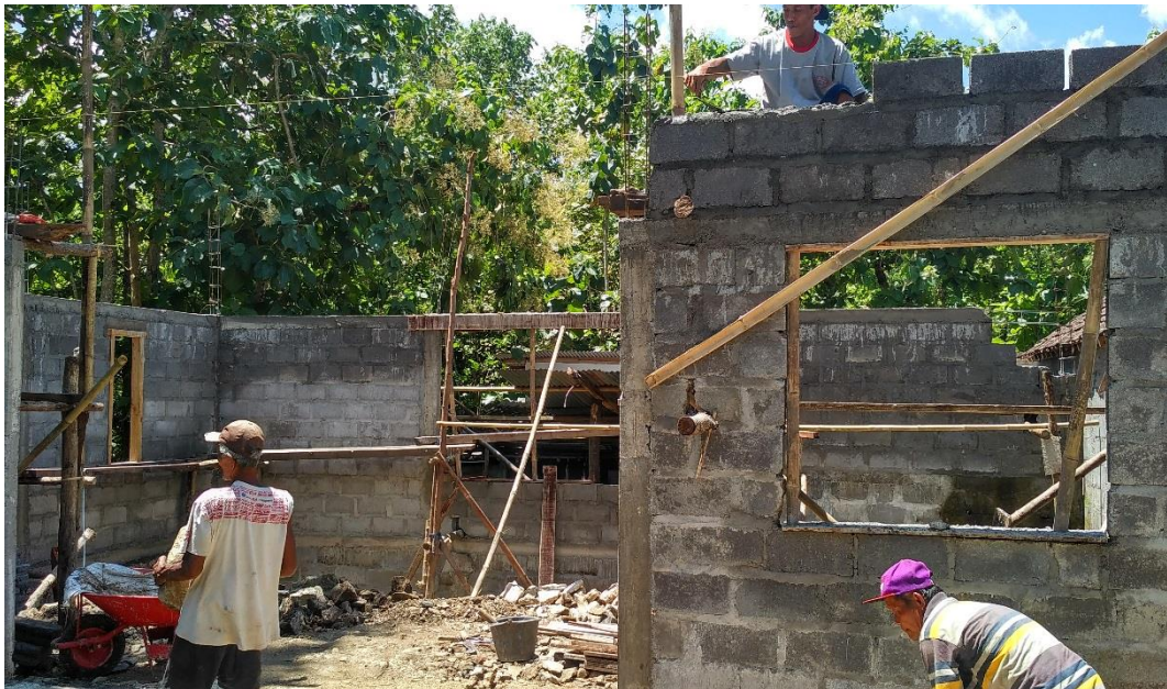
Foto 21 Tampak depan bangunan ketujuh, para pekerja sedang melakukan tugas masing-masing, fungsi bangunan adalah sebagai warung/toko.
