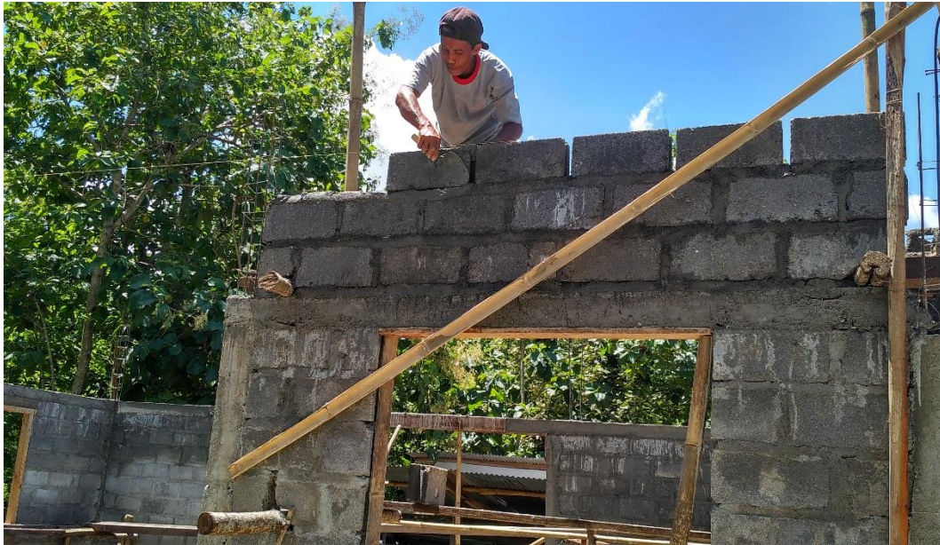
Foto 21 Pekerja sedang melakukan pemasangan batu batoko sebagai dinding bangunan, batu batako digunakan dalam pembangunan dengan alasan agar bangunan cepat selesai.
