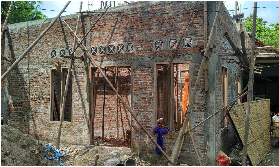
Foto 20 Tampak samping bangunan, terlihat masih ada bambu yang menempel pada bangunan bekas pembagunan balok dan kolom bangunan, fungsi bangunan adalah rumah tempat tinggal.
