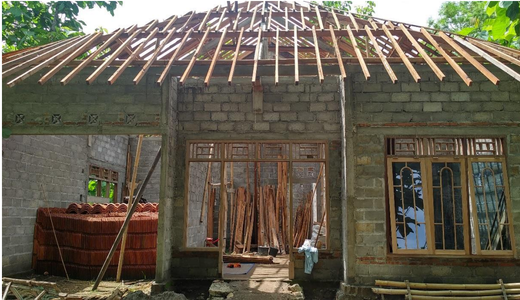
Foto 18 Lokasi bangunan rumah kelima tahap pembangunan rangka atap menggunakan kayu yang ada ditempat, bahan genteng juga sudah tersedia setelah pembangunan rangka atap selesai tahap selanjutnya adalah pemasangan genteng, dinding menggunakan batu batako yang belum dipleser, bangunan berfungsi untuk rumah tinggal.
