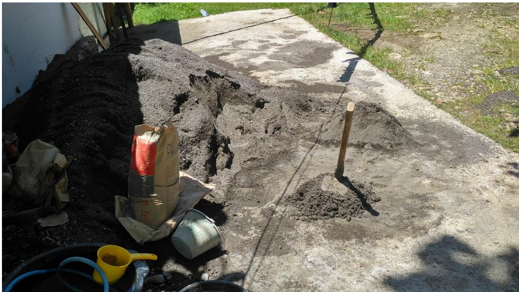
Foto 24 Adukan atau campuran yang digunakan untuk pembuatan beton (balok dan kolom) dengan perbandingan 1 Semen : 2 Pasir : 3 Kerikil.
