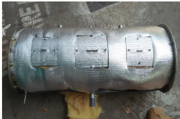
Gambar 3. 7. Tangki solar water heater sudah terpasang glasswool dan aluminium foil.
