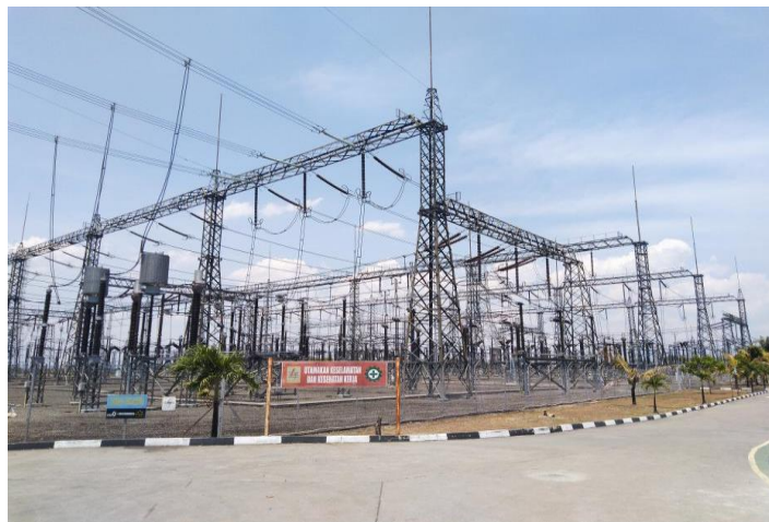
Gambar 2.1. Switchyard pada Gardu Induk
