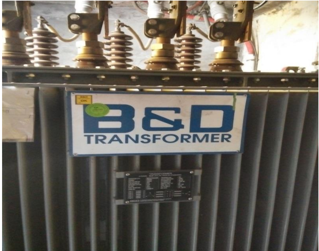
Lampiran 3. Gambar Trafo serta Nameplat
