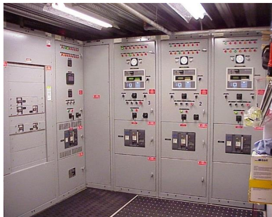
Gambar 2.15 panel tegangan menengah
