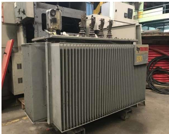
Gambar 2.14 Trafo Step Down Merk Tranfindo
