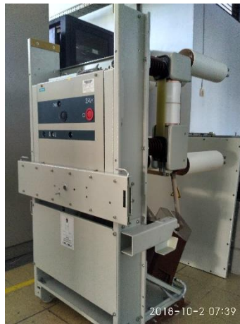
Gambar 2.11 Ilustrasi CB di Kontrol Panel Incoming Trafo 3
