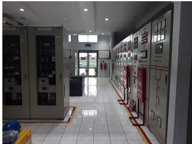
Gambar 2.13 Panel Kontrol PLN ULTG Yogyakarta
