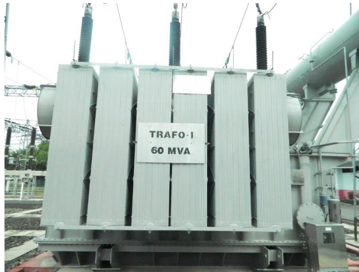
Gambar 2.3 Transformator 1 di Gardu INDUK PLN ULTG Yogyakarta
