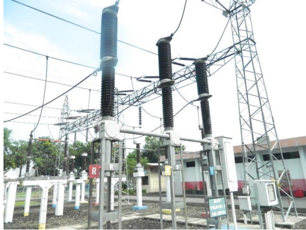
Gambar 2.10 PMT 150 KV PLN ULTG Yogyakarta
