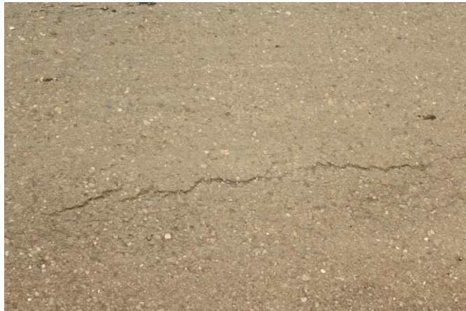
Gambar kerusakan retak memanjang
