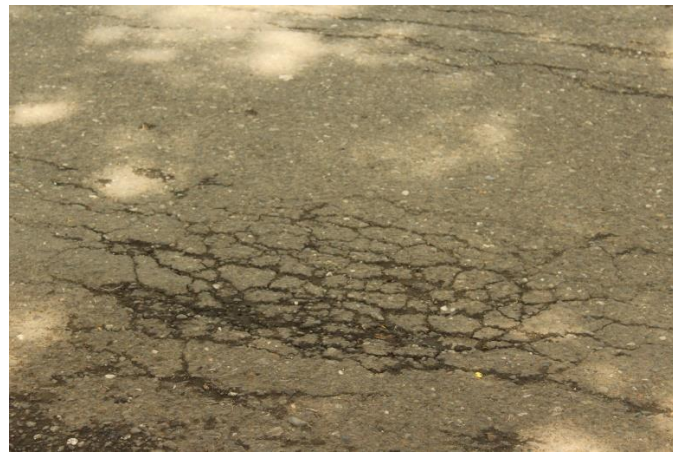
Gambar kerusakan retak buaya
