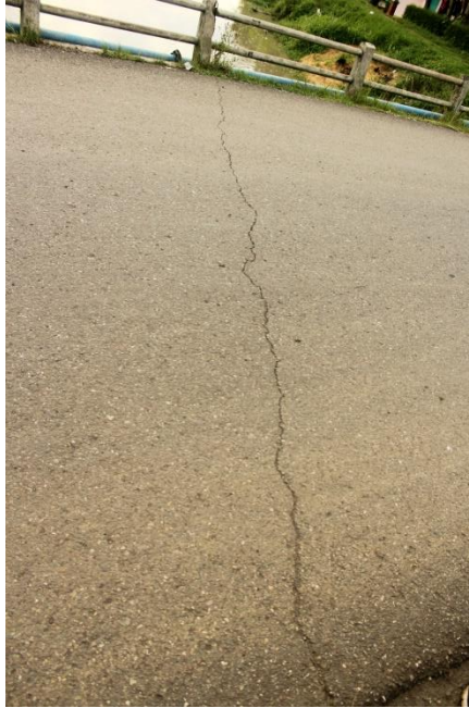
Gambar retak sambungan
