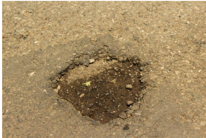
Gambar kerusakan lubang
