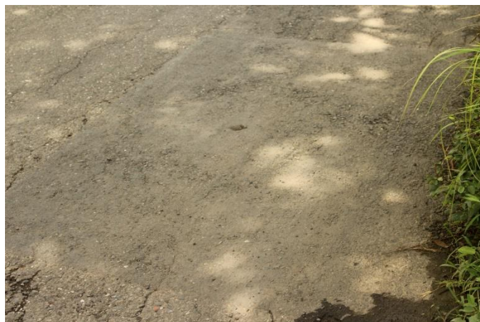
Gambar kerusakan tambalan
