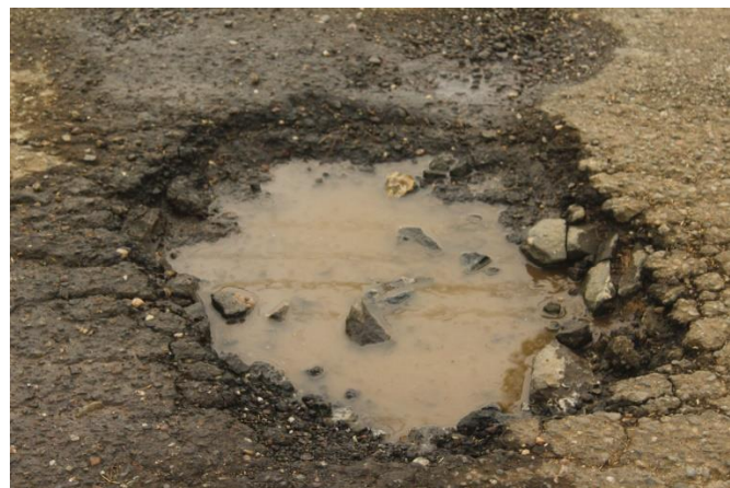
Gambar kerusakan lubang
