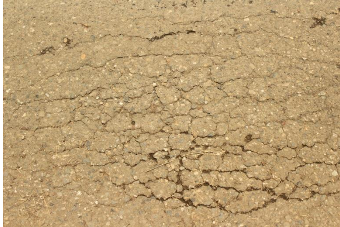
Gambar kerusakan retak buaya
