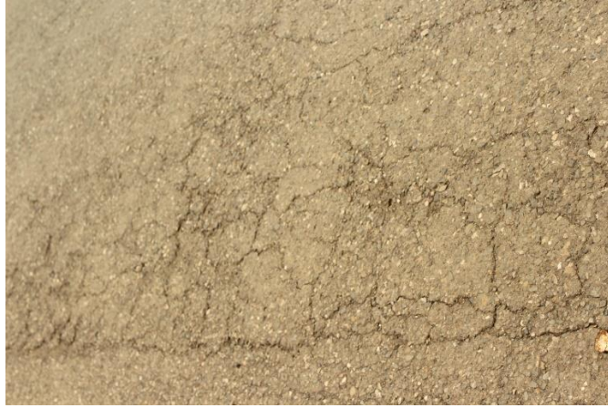
Gambar kerusakan retak kotak – kotak
