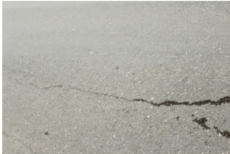
Gambar kerusakan retak memanjang
