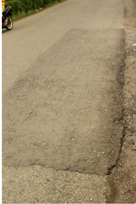
Gambar kerusakan tambalan
