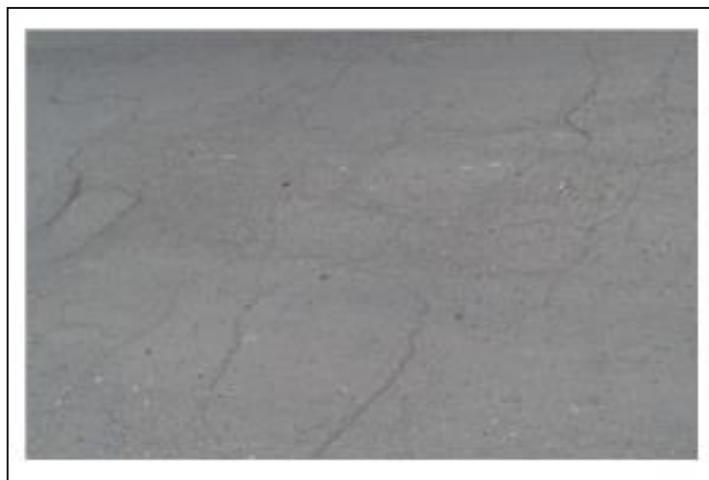
Gambar 2.7 Retak Kotak-kotak ( Block Cracking )
