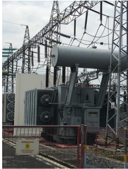
Gambar 2.1. Transformator Daya 60 MVA GI Kentungan
