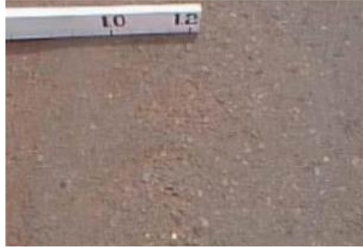
Gambar 2.23. Kerusakan pengausan agregat (Bina Marga, 1983).
