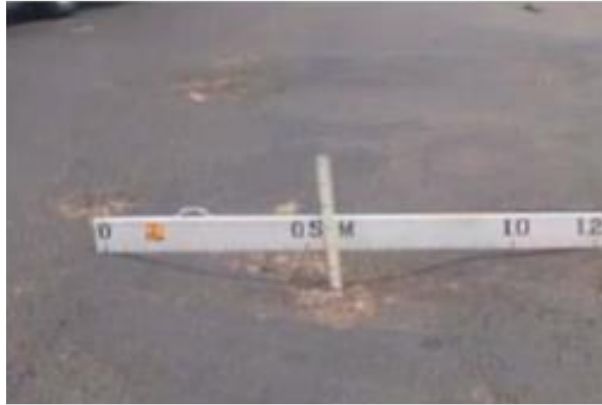
Gambar 2.11. Kerusakan amblas (Bina Marga, 1983).
