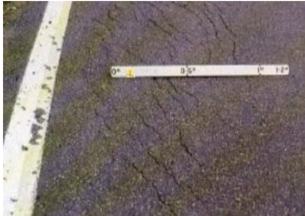
Gambar 2.33. Kerusakan patah slip (Bina Marga, 1983).
