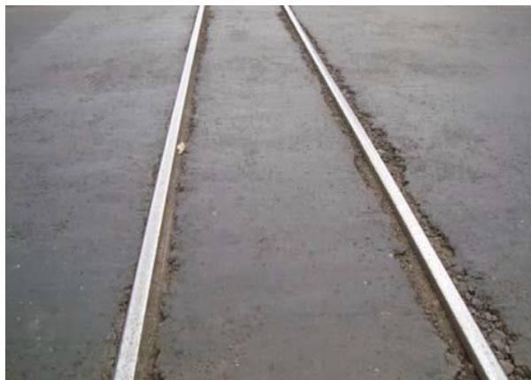
Gambar 2.27. Kerusakan rusak perpotongan rel (Bina Marga, 1983).
