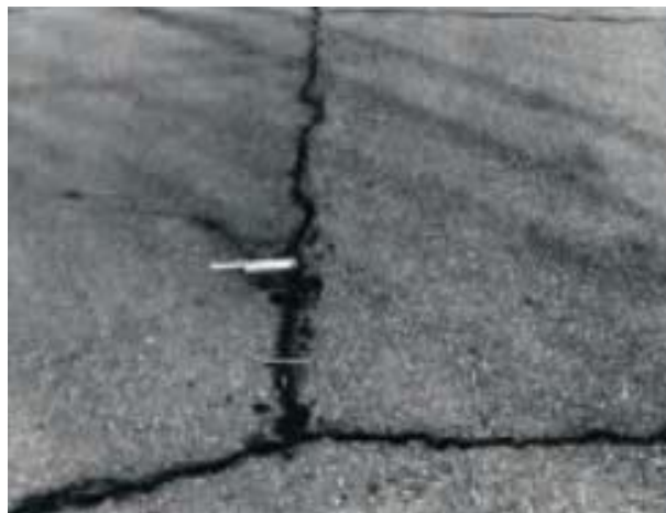
Gambar 2.15. Kerusakan retak sambung (Bina Marga, 1983).
