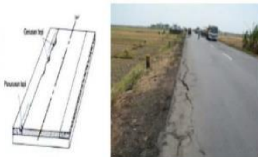
Gambar 2.13. Kerusakan retak pinggir (Bina Marga, 1983).
