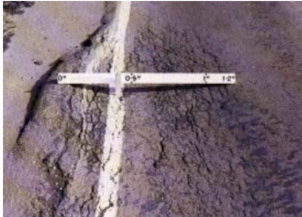
Gambar 2.31. Kerusakan sungkur (Bina Marga, 1983).
