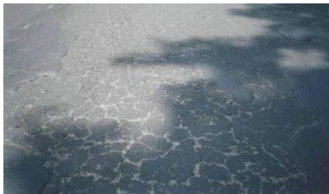
Gambar 2.37. Kerusakan pelepasan butir (Bina Marga, 1983).
