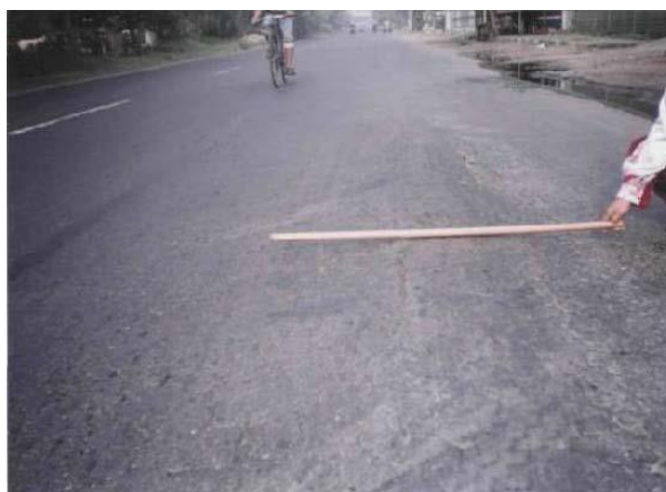
Gambar 2.35. Kerusakan mengembang jembul (Bina Marga, 1983).
