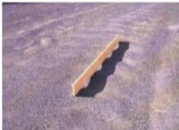
Gambar 2.9. Kerusakan keriting (Bina Marga, 1983).
