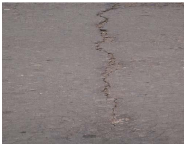
Gambar 2.17. Kerusakan pinggiran jalan turun vertikal (Bina Marga, 1983).
