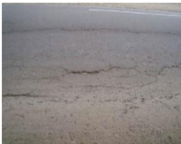
Gambar 2.7. Kerusakan cekungan (Bina Marga, 1983).
