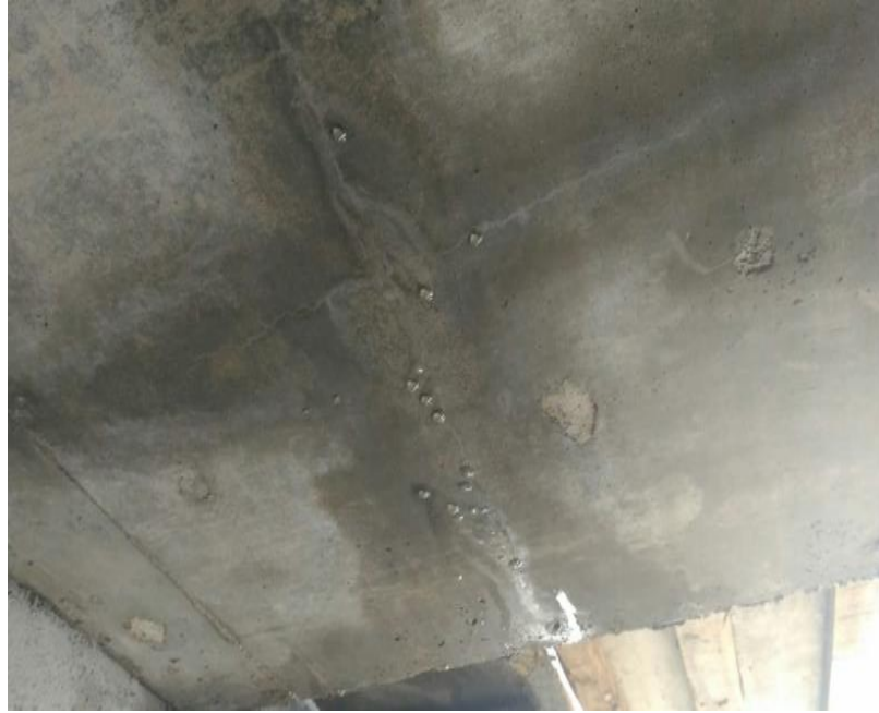
Gambar 4.12 Kebocoran pada area yang belum dilakukan waterproffing
