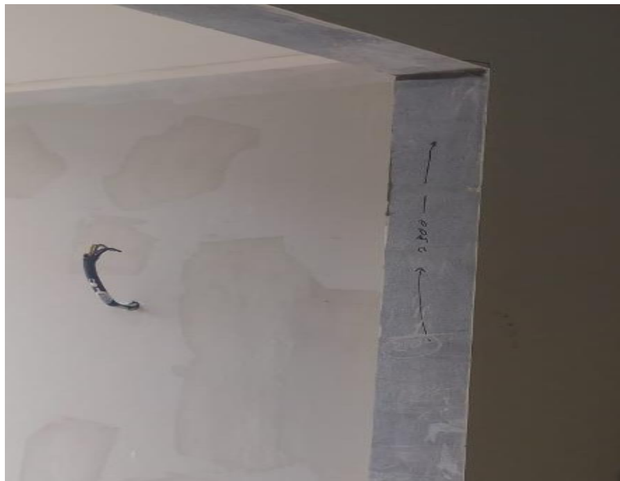
Gambar 4.9 Dinding beton untuk pemasangan kusen yang tidak sesuai ukuran
