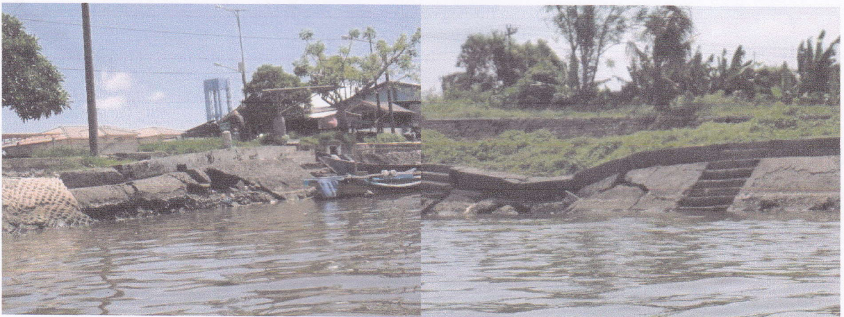
Foto 2. Terjadinya Gerusan Pada Pengaman Tebing Sungai Kali Yasa
