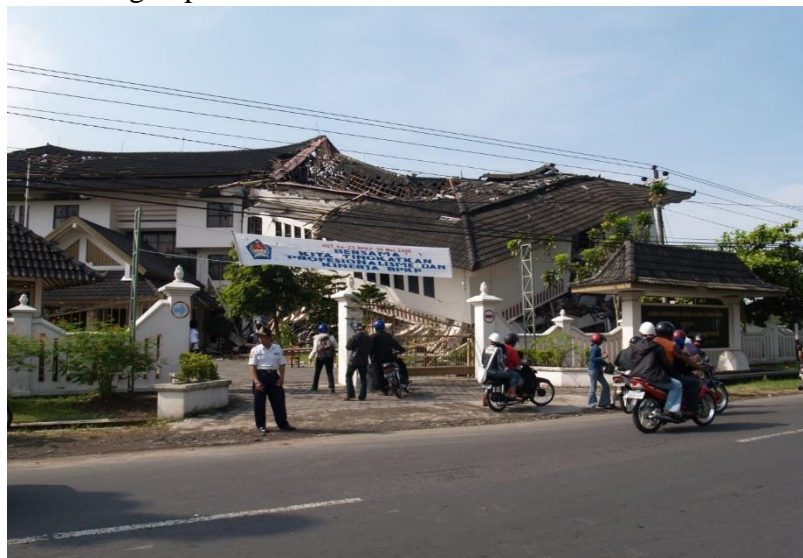
Gambar 1.2 Kerusakan yang diakibatkan gempa bumi (Wikipedia.org, 2018).
