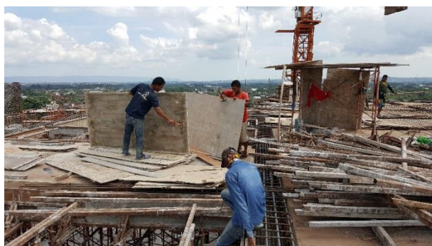
Gambar 2 Pekerjaan Perakitan Body Bekisting Kolom dan Dinding Pada Proyek Pembangunan Gedung C Universitas Aisyiyah Yogyakarta
