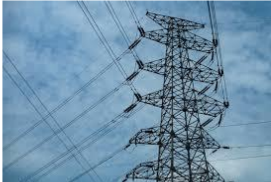
Gambar 2.5 Saluran Udara Tegangan Tinggi (SUTT)
