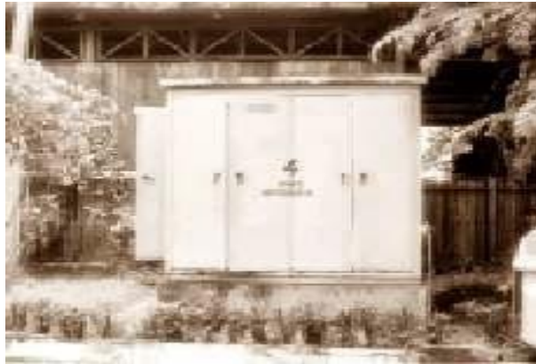
Gambar 2.3 Gardu Besi (kios)
