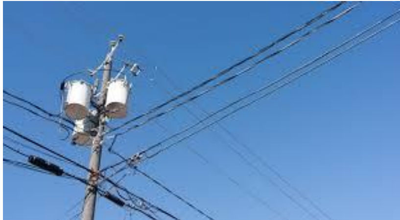
Gambar 2.7 Jaringan Tegangan Rendah
