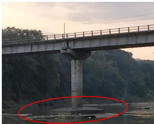
Gambar 4.44 Pilar jembatan yang mengalami degradasi
