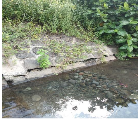
Kerusakan pada dinding penahan tanah
