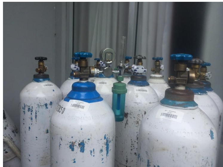
Penyimpanan Gas Medis
