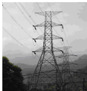
Gambar 2.1 Saluran Transmisi Udara
