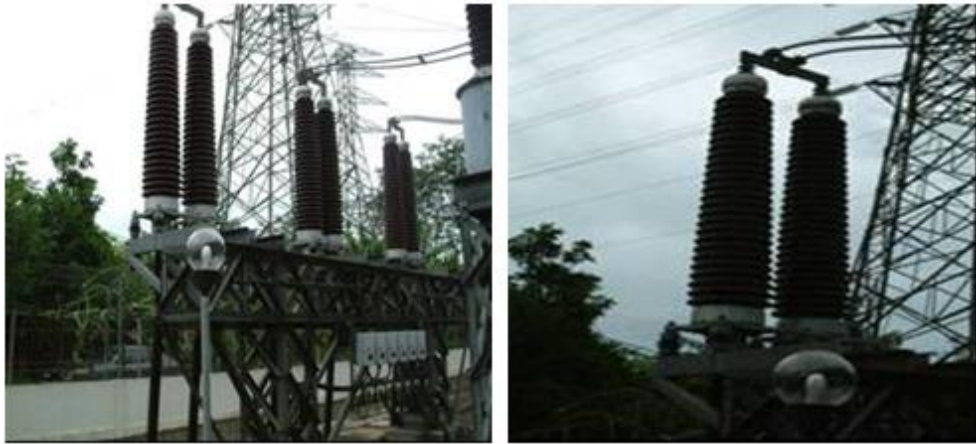
Gambar 2.3 Sealing atau Cable Head (Terminal Out Door)
