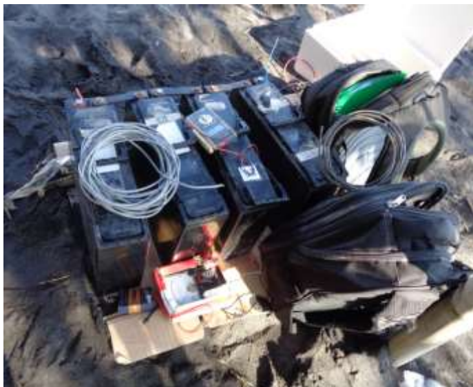
Gambar 4.4. Baterai 12 V, 4 x 100 Ah untuk pengujian pembebanan wind turbine 2 kW di Pantai Baru, Bantul
