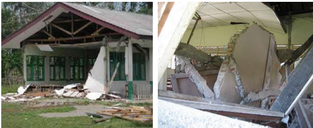
Gambar 2.3. Pergeseran horisontal yang mengakibatkan elemen struktur (kolom & ringbalok) lepas.
