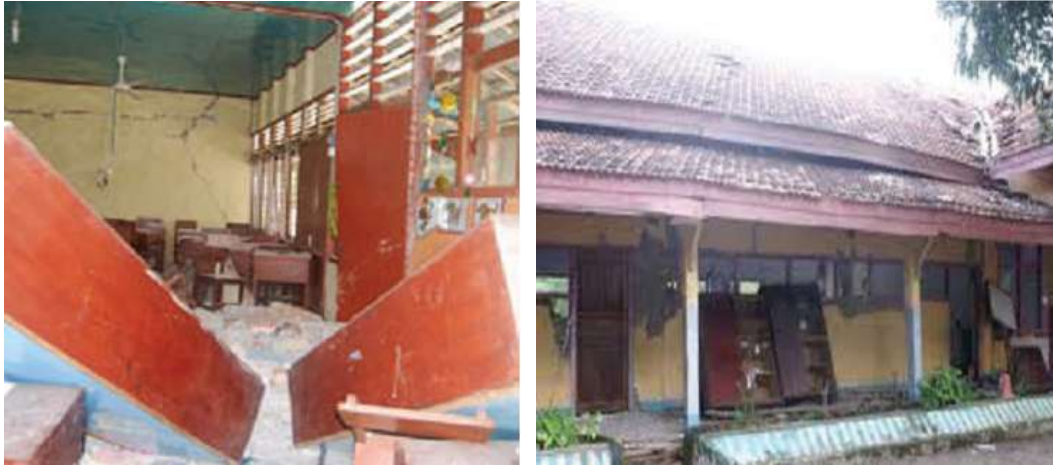
Gambar 2.2. Kerusakan bangunan sekolah pada dinding, rangka pintu dan jendela.
