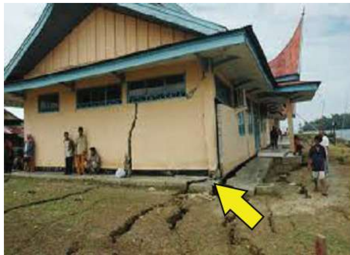
Gambar 2.1. Retakan Tanah yang mengakibatkan Fondasinya Retak (Padang, 2010)
