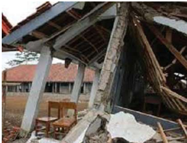
Gambar 2.5. Robohnya bangunan sekolah.
