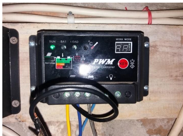
Gambar 4.3 Solar Charge Controller yang digunakan pada PLTS di Batik Tugiran
