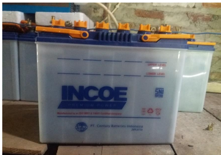
Gambar 4.2 Baterai yang digunakan pada PLTS di Batik Tugiran
