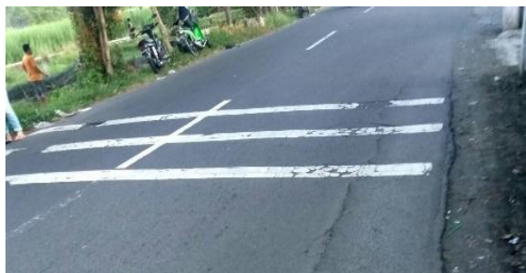
Gambar 8 Pita Penggaduh ( rumble strip ).
