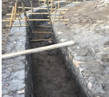
Gambar 4.3 Pasangan batu dengan mortar
