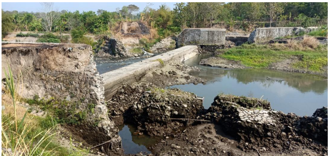
Bendungan tegal yang jebol mengakibatkan banjir di kecamatan Imogiri
