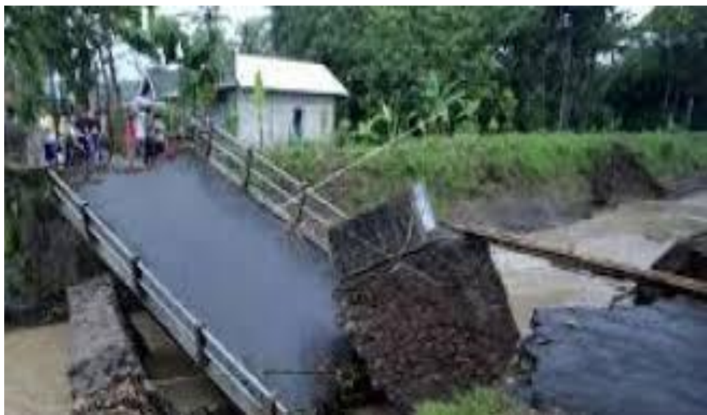
Kondisi Jembatan yang Rusak Akibat Banjir di Daerah Imogiri
